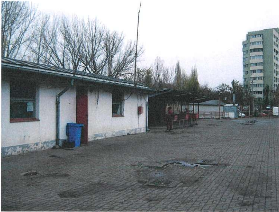
Vedere exterioara – Constructie – acces birouri – se poate observa deteriorarea fatadei.
