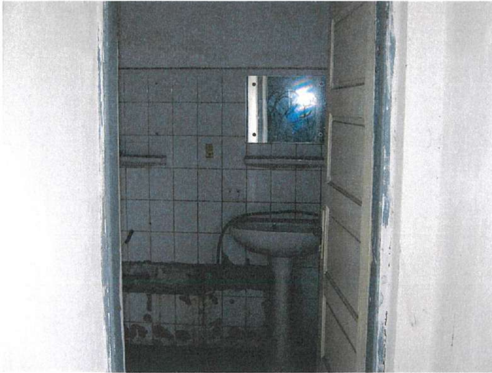
Vedere interioara – Constructie C1 – gup sanitar – se poate observa deteriorarea placajelor ceramice si a utilitatilor
